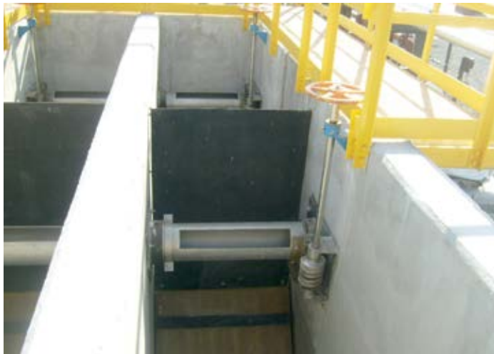
FIGURA 9.11 Tanque separador de óleo com removedor de óleo livre com calha coletora
