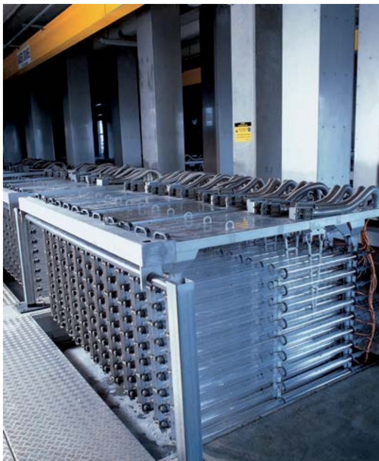
FIGURA 16.2 Unidade de ultravioleta
