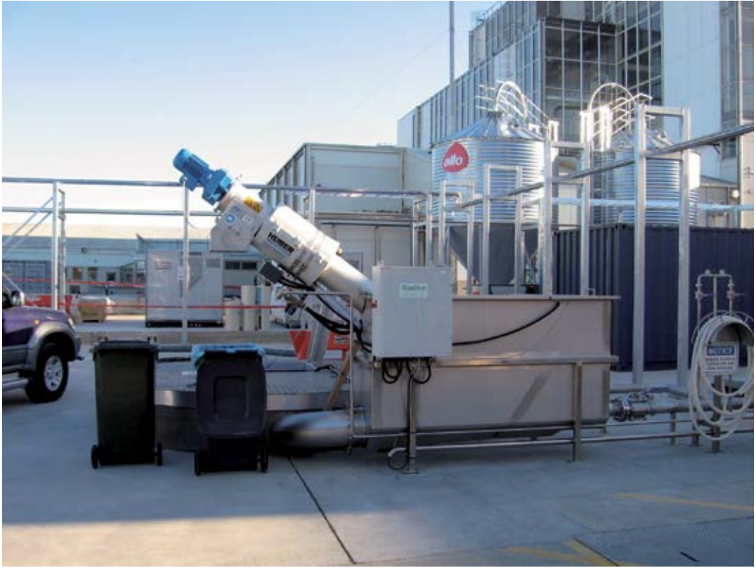
FIGURA 9.5: Peneira rotativa de malha fina instalada em canal
