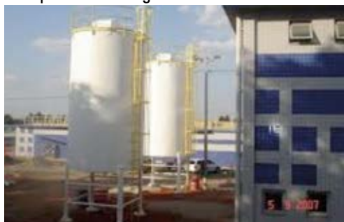
FIGURA 10.2 Tanque de estocagem de Hidróxido de Cálcio
