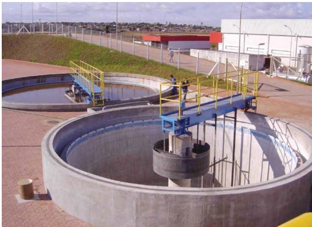
FIGURA 12.21 Decantador secundário: removedor de lodo com tração periférica
