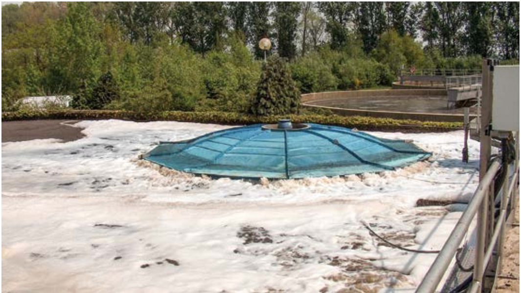
FIGURA 12.34 Aerador flutuante de alta rotação com cobertura
