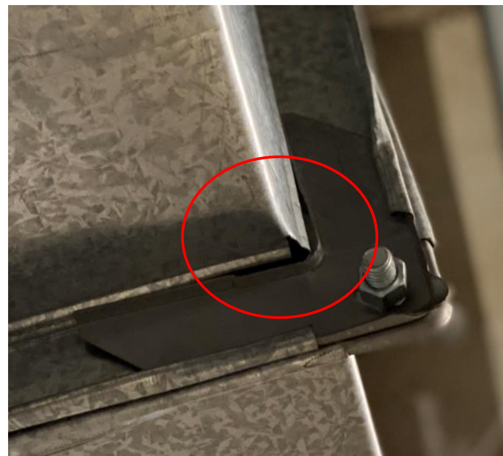
Flanges de Dutos com vazamento
