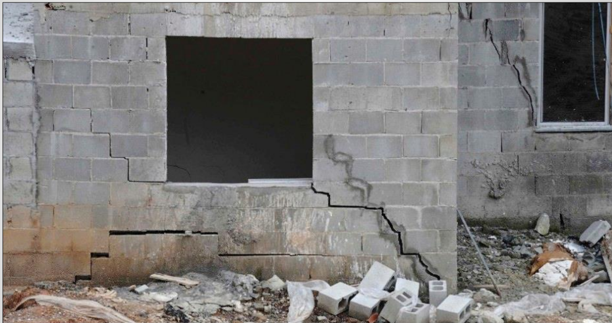
Imagem 1/15: A Defesa Civil de Niterói (RJ) vistoriou prédios que integram o conjunto Zilda Arns 2 e que ameaçam cair. Os imóveis foram construídos com recursos do Minha Casa Minha Vida para os sobreviventes do deslizamento do morro do Bumba, em 2010. Cada prédio custou R$ 2 milhões MAIS Fabio Teixeira/UOL
