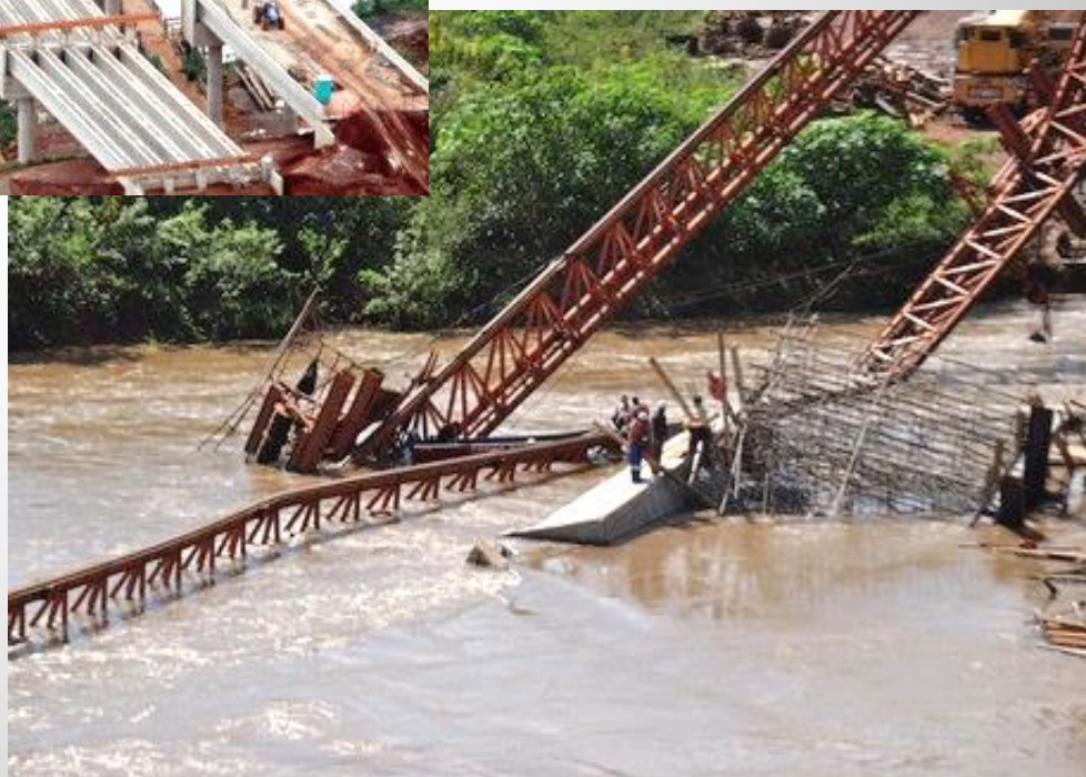
DESABAMENTO DE PONTE EM PIRACICABA- 01/07/2013
