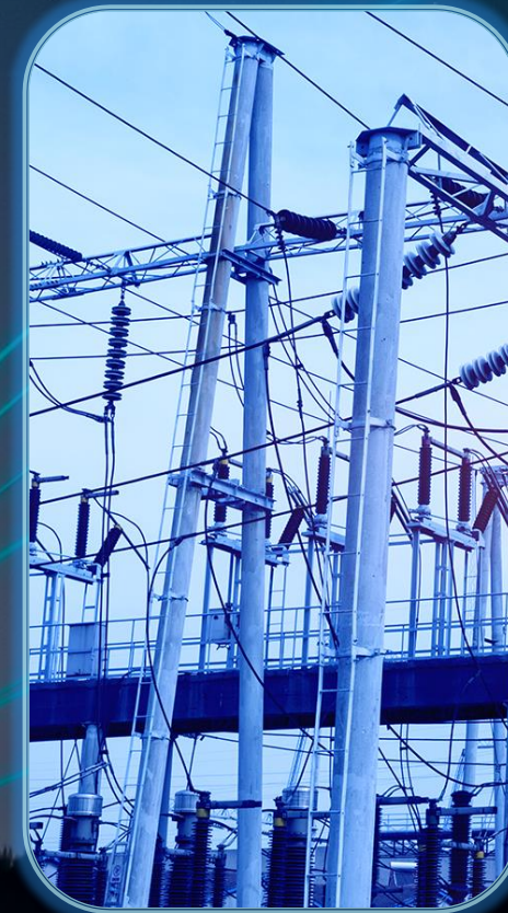
Subestações digitais Subestação 4.0
