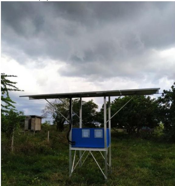
Sistema SIGFI, sob o tempo encoberto, ainda entregando energia.
