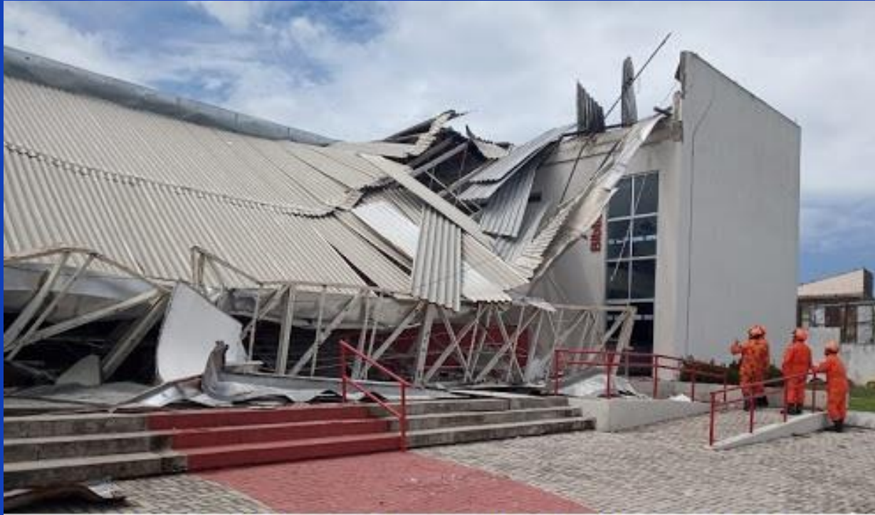
Escola cujo teto desabou já apresentava problemas estruturais
