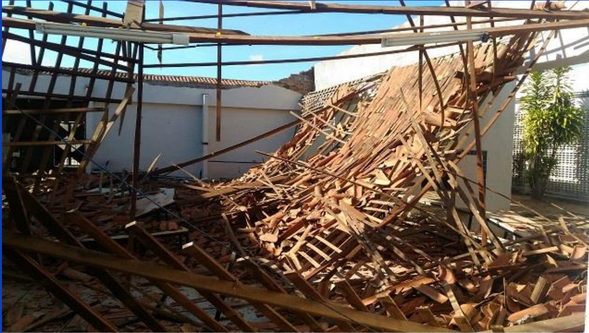
Um ano após reforma, teto desaba em escola de Penedo
