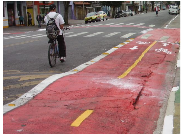
Lombada e pista danificada
