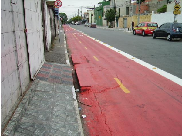
Guia rebaixada irregular
