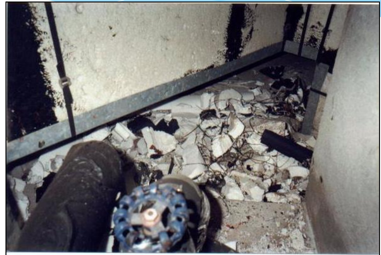
Retorno de ar sob piso
