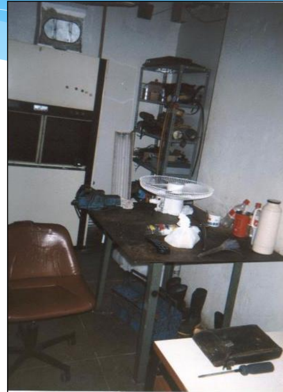
Casa de máquinas inadequada
