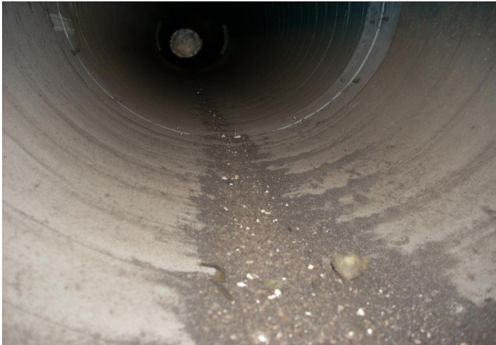
Duto Insuflamento Redondo
