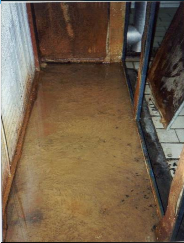
Bandeja do evaporador do condicionador de ar
