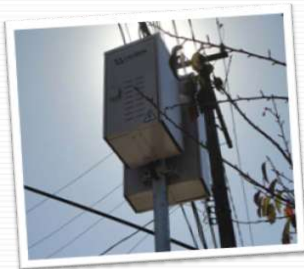
Instalação de No-Break
