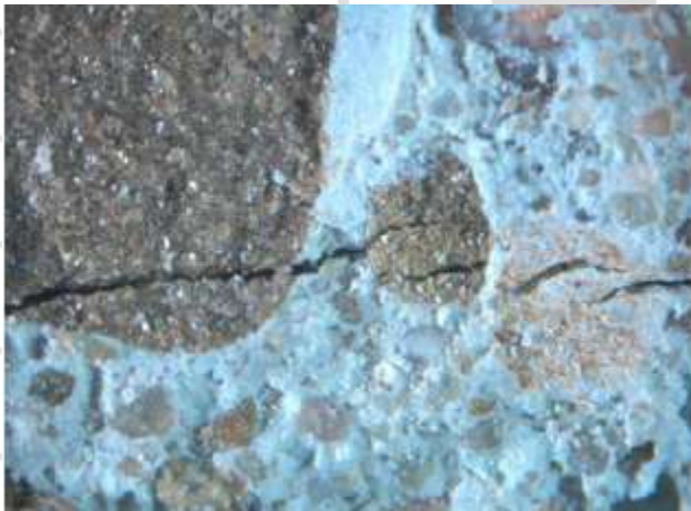
Imagem inicial de fissura com 0,4 mm
