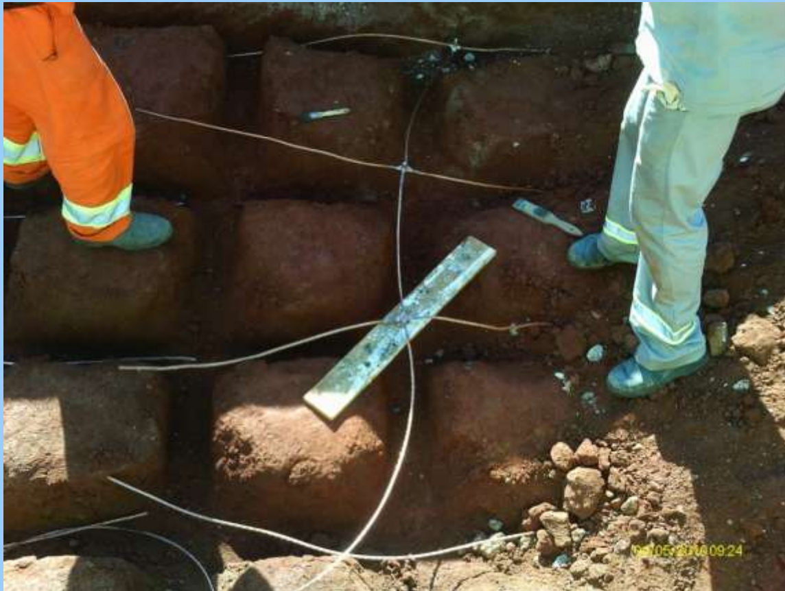
Malha de Terra
