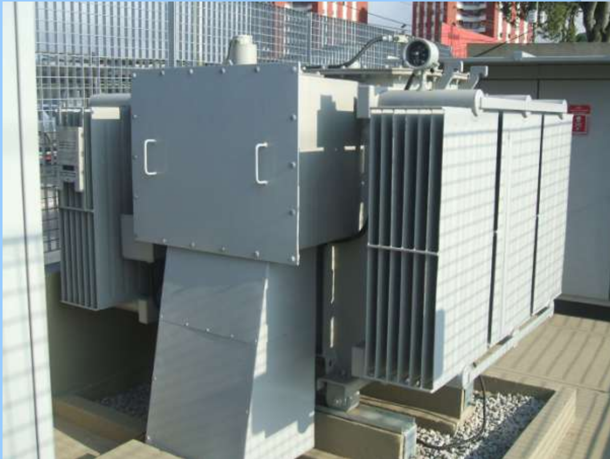
Transformador de 825 kVA
