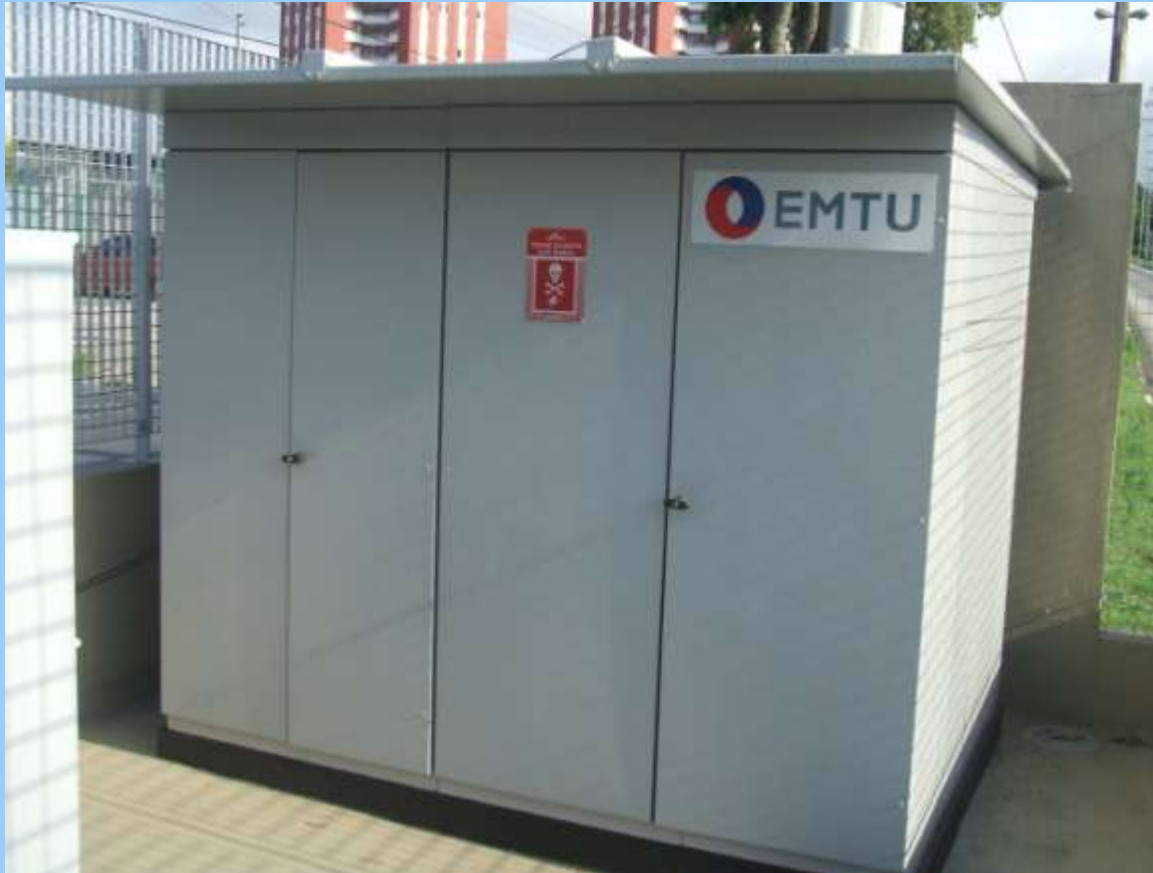
Cabine de medição e proteção em média tensão
