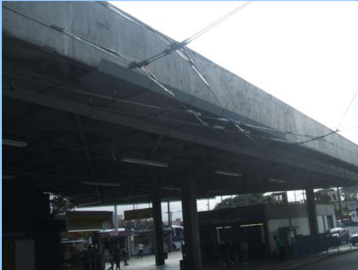
Rede Aérea Rígida no Terminal Jabaquara
