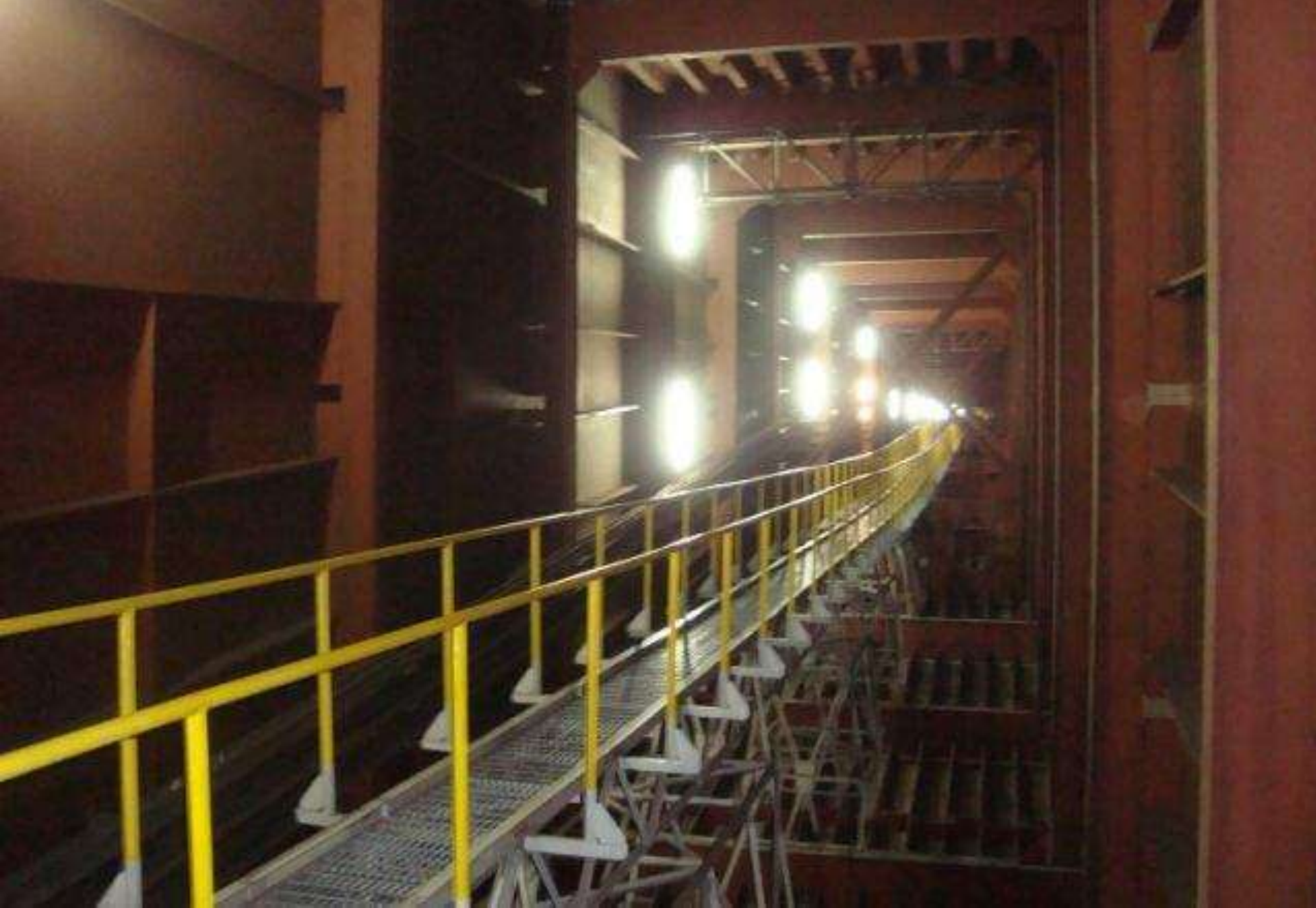
PASSARELA PARA MOVIMENTAÇÃO INTERNA NOS CAIXÕES
