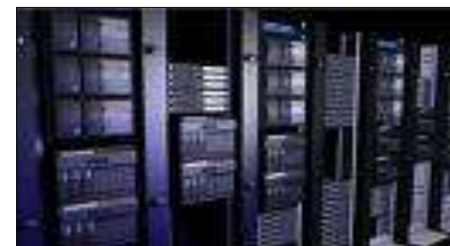
Data Center e Comunicação On-line
