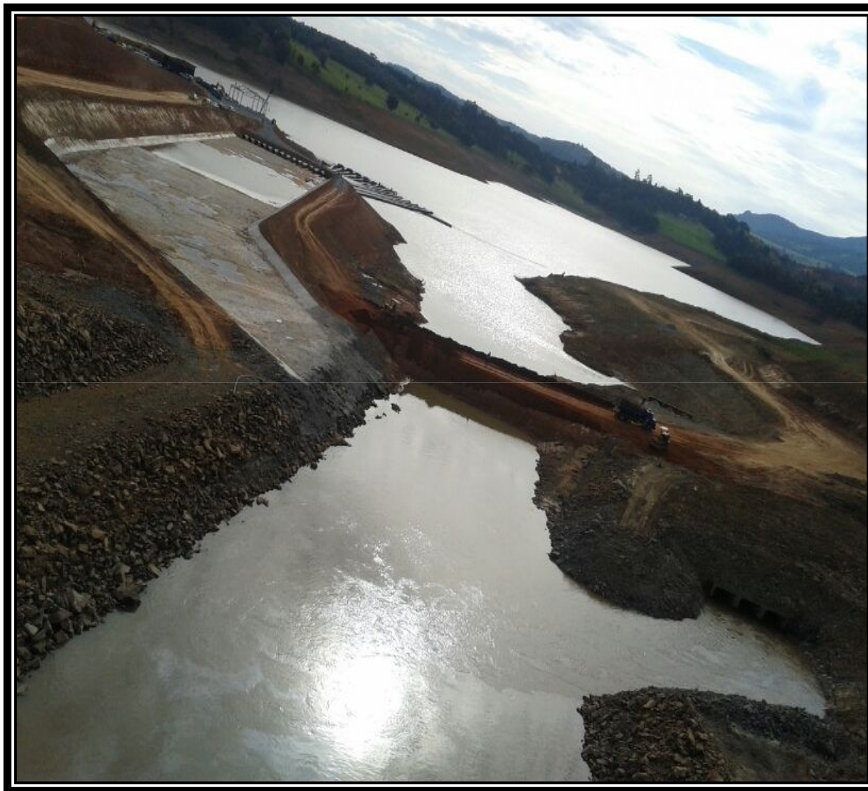
14/05/2014 – Todos os equipamentos instalados para funcionamento.
