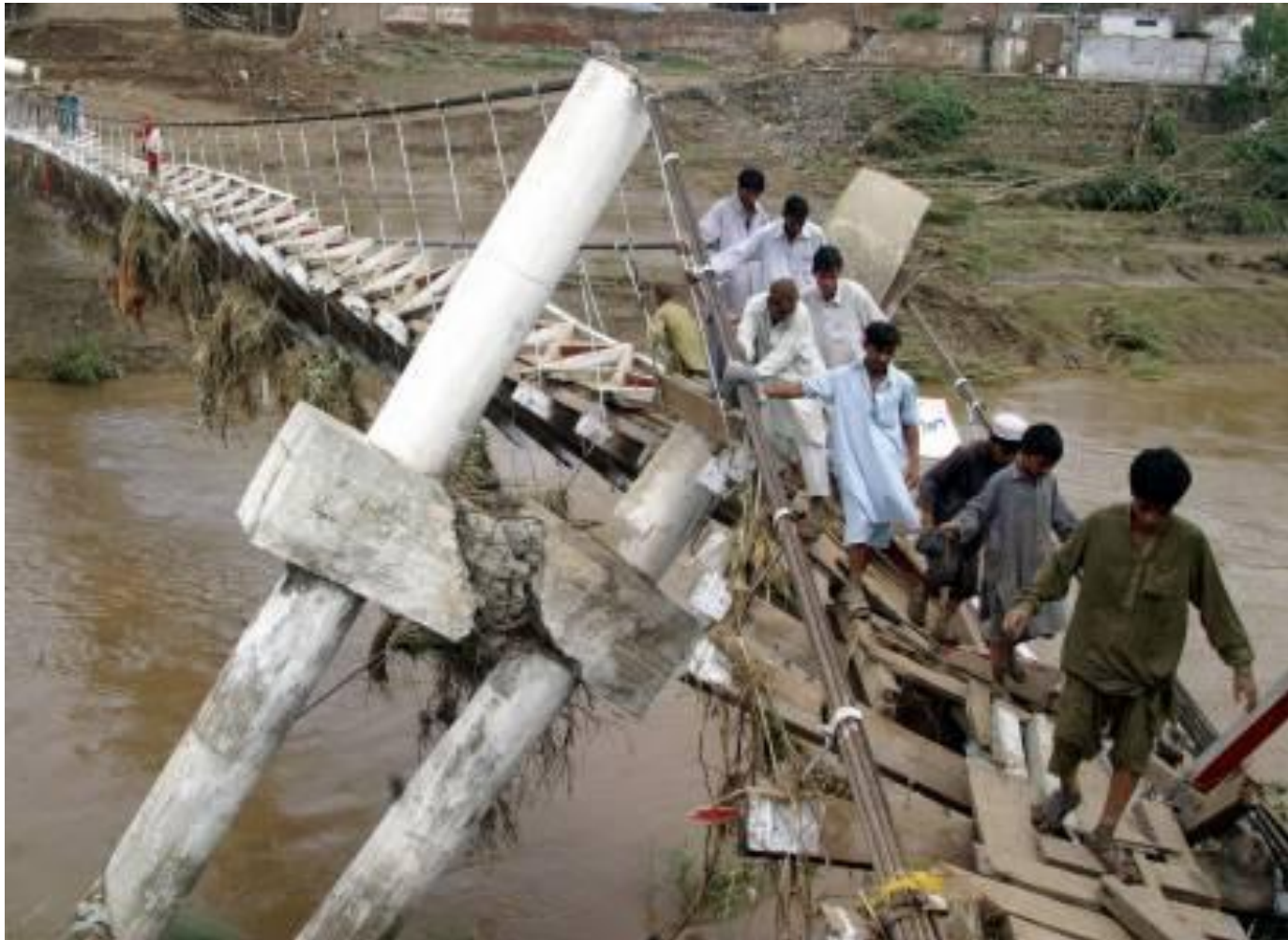
Passarela semi-destruída em Mardan, Paquistão – agosto 2006
